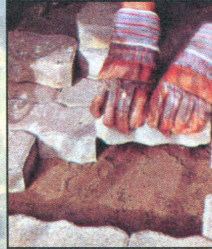
Бетонные блоки просто свободно укладывают.
